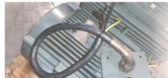
Câble d'alimentation en bon état
